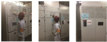
高压柜停止 低压柜分闸 变压器节能停止
